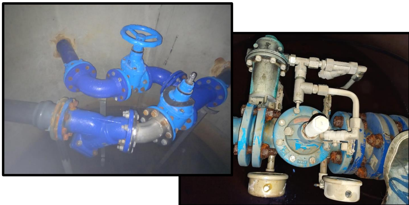
Obrázek 9 Armaturní šachty – rozdělovací šachta, redukční ventil pro Rakov
