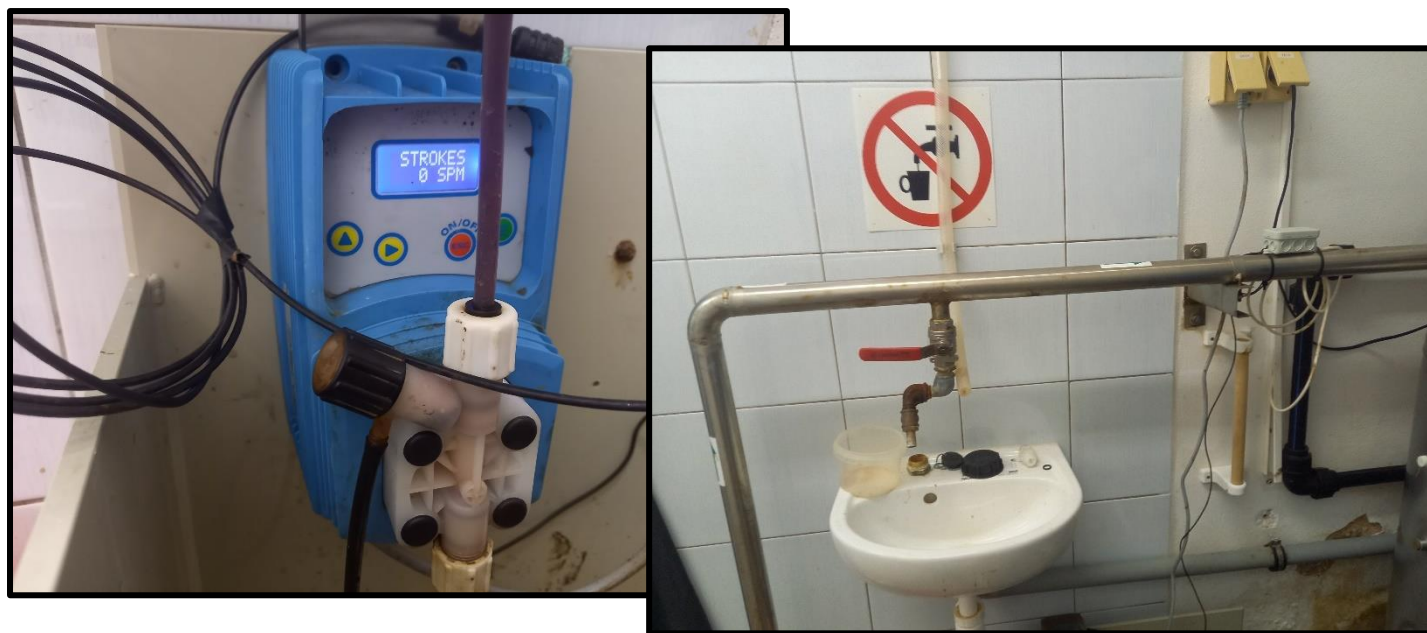
Obrázek 6 Dávkování chlornanu sodného s manganistanem draselným, umyvadlo pro oplach
